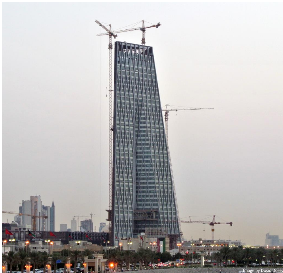
Das neue Headquarter – Central Bank of Kuwait bei Morgendämmerung
